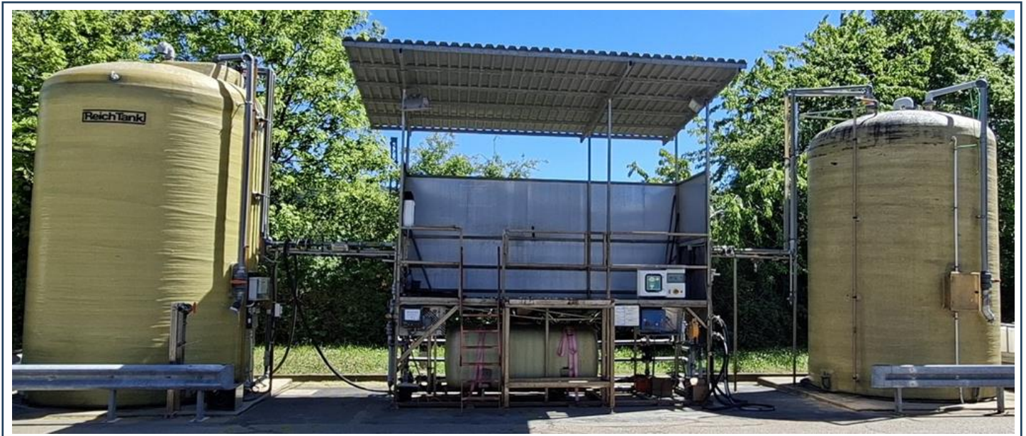
Abb. 2: Altanlage mit Solelagertanks
